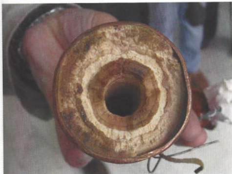
Das sehr heie, eisenhaltige Mineralwasser verstopft mit der Zeit die Rohre.
